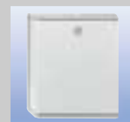
Informations- und fernmelde-technische Kabelverzweiger
